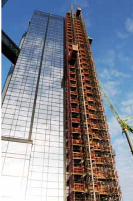
Fasadarbete. Fasaden är nästan klar men på insidan är det mycket kvar att göra.
