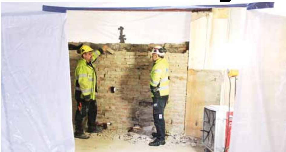
Dammfri zon. Genom att skapa undertryck kan Peo Olsson och Tony Törnevik leda bort dammet och därmed skapa en bättre arbetsmiljö på Annedalsskolan.
