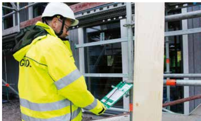
Niklas Nordlund inspekterade byggnadsställningar och fann både sådana som var bättre och andra som var så dåliga att han stoppade arbetet. Foto: Privat
