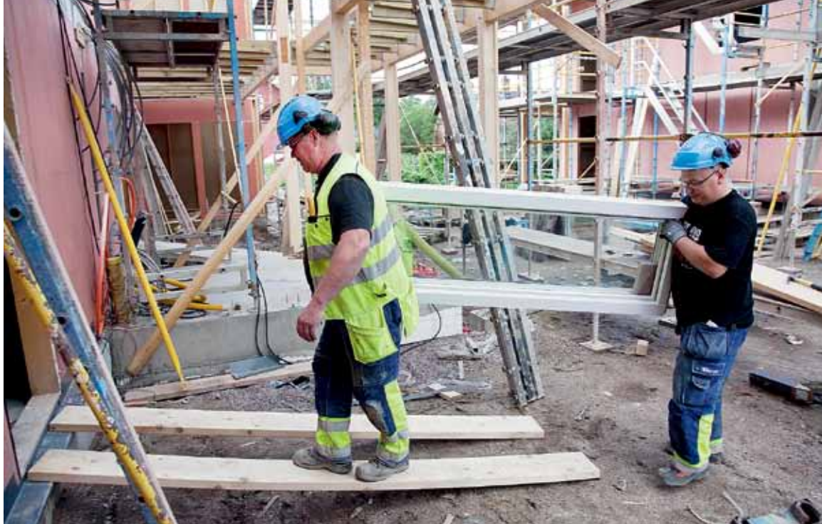
Fem hus med totalt 20 hyreslägenheter byggs just nu i Hallsberg. Här bär Tonny Karlsson fönster som ska sättas på plats. Till sin hjälp har han Marcus Kaarlejärvi.
