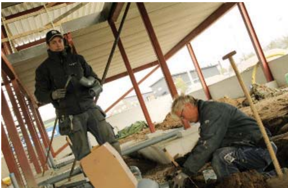
VVS-montörerna Fredrik Wremstad och Sven-Olof Augustsson lägger här avlopp i en blivande platta. De har en betydligt högre inkomst än de som tjänar sämst av Byggnads medlemmar.
