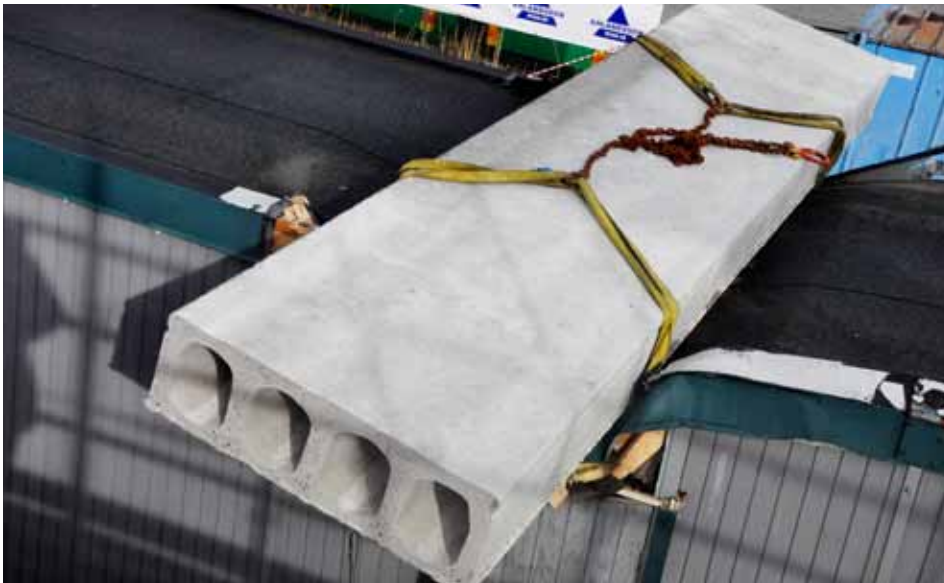
Orsaken till olyckan. Ett betongblock har ramlat över byschan och skadat tre personer.
