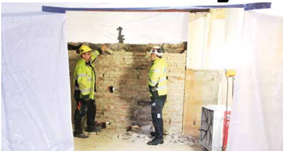
Dammfri zon. Genom att skapa undertryck kan Peo Olsson och Tony Törnevik leda bort dammet och därmed skapa en bättre arbetsmiljö på Annedalsskolan.
