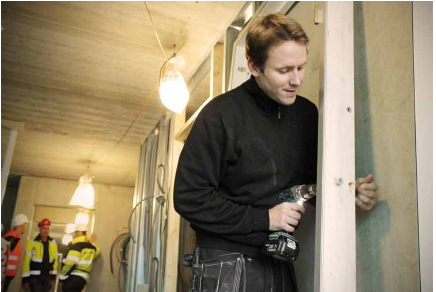
Dörrmontering. Thomas Emet monterar balkongdörren till en av lägenheterna. I bakgrunden syns Mikael Varde från Riksbyggen, Tomas Lundin från Byggnads Väst och Roger Sjöo från RO-Gruppen.
