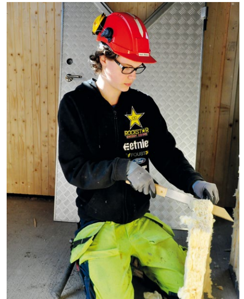
Arbete pågår. Kevin Moberg skär till isoleringen som ska användas inne i bastun.
