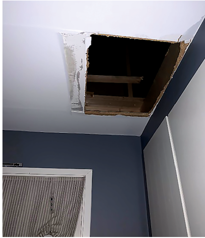
GENOM TAKET. Sebastian ramlade rakt igenom innertaket och ner i golvet.
