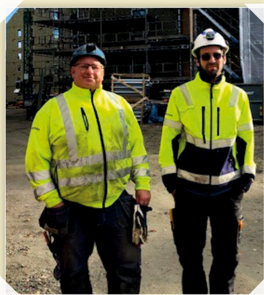
13 OKTOBER. Arbetsplatsbesök på Sven Brolids väg 15 i Sandarna, Göteborg. Skanska Sverige AB är huvudentreprenör och bygger studentlägenheter åt SGS. På bild Martin Andersson, MB-ledamot på företaget, och platschefen Erik Martin.
